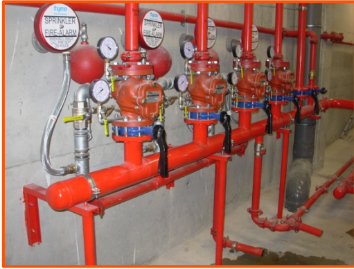
Protección contra incendios
